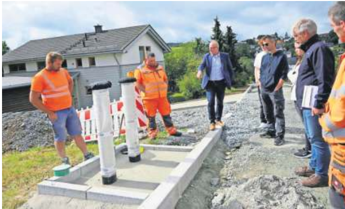
Die Entlüftung gehört zur unterirdisch eingebauten Druckausgleichsstation.
