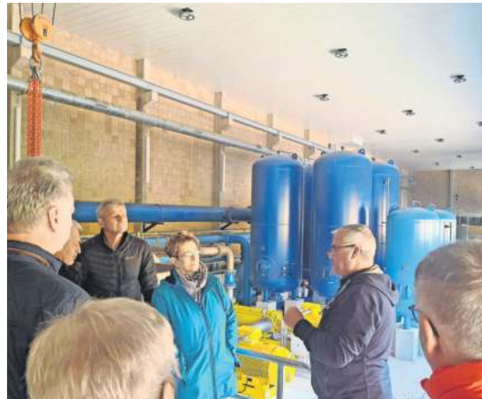
Im Pumpwerk der TWA in Rieblach.
