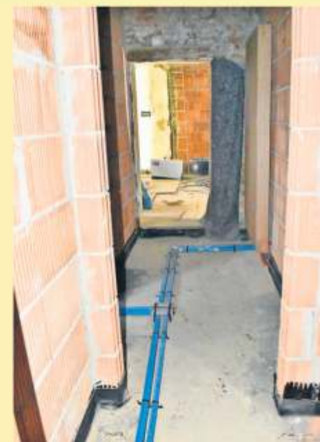
Heizungsrohre am Boden
